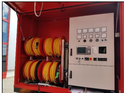
Schaltschrank und Kabeltrommeln
