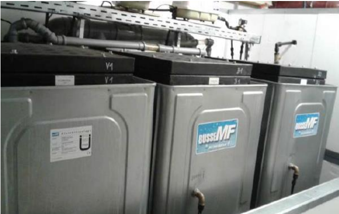
Abb.4) Klärtanks zur mechanischen und biologischen Reinigung
