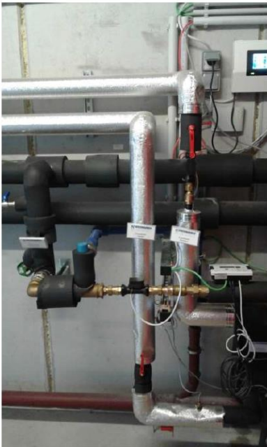
Abb.10) Zulauf von Kaltwasser und Grauwasser-Filtrat zum Plattenwärmetauscher
