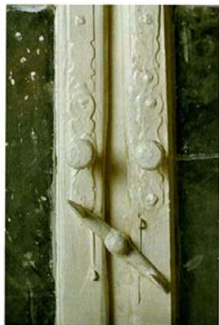
Fensterbeschläge sind auch materielle Zeugen der Handwerkskultur und als solche wertvoll und zu erhalten
