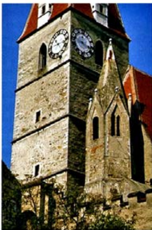
Weißkirchen, Pfarrkirche, Verputz 14. Jh. (kleiner Turm), geglättete Fresko- färbelung; Hauptturm, dat. 1502, mit späteren Reparaturen Vor der Restaurierung
