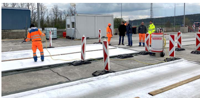
Seuchenteppiche werden vom NÖ Straßendienst betreut, um eine Einschleppung der Maul- und Klauenseuche über den Straßenweg möglichst zu verhindern. Foto: zVg Schabas
