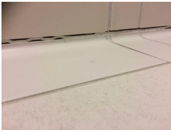
Hohlkehlen-Fliese RICHTIG verlegt (liegend). Wasser kann trotz bereits undichter Silikon-Fuge nicht in die Mauer eindringen
