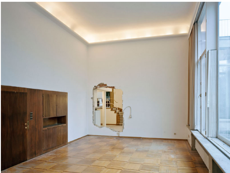
Haus Beer, Wien: Parkettboden im Speisezimmer, Kontrastverlust durch Lichteinwirkung, Zustand im Jahr 2012
