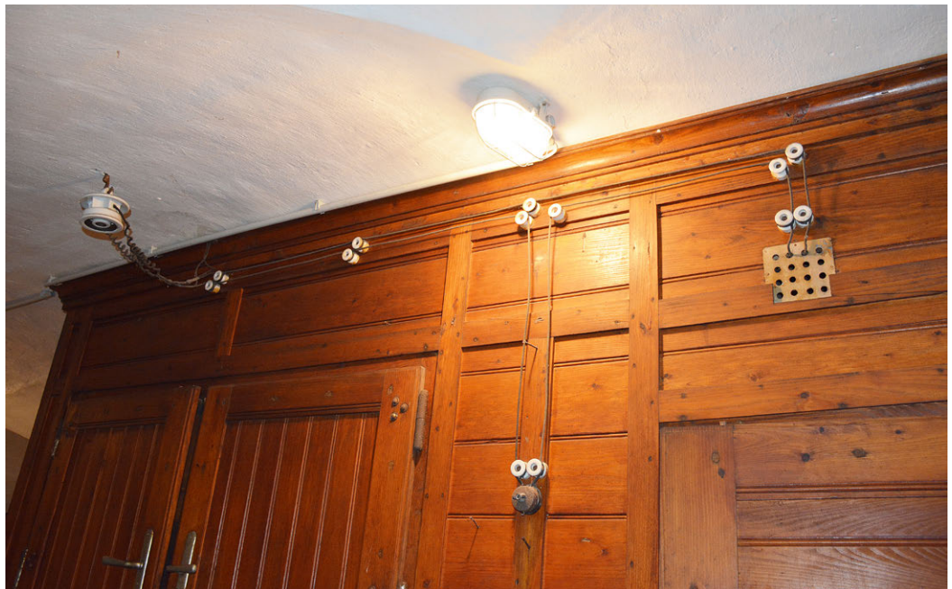
Eiskasten mit historischer Verkabelung auf Isolierrollen im Jagdschloss Eckartsau, Anfang 20. Jahrhundert
