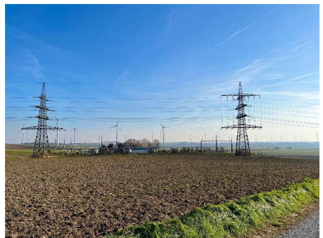
Umspannwerk Petronell südlich der Siedlung Schaffelhof (Quelle: eigene Aufnahme)
